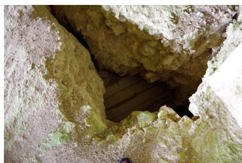
Figure 9: Batterie Coidavid - Voûte défailtante
